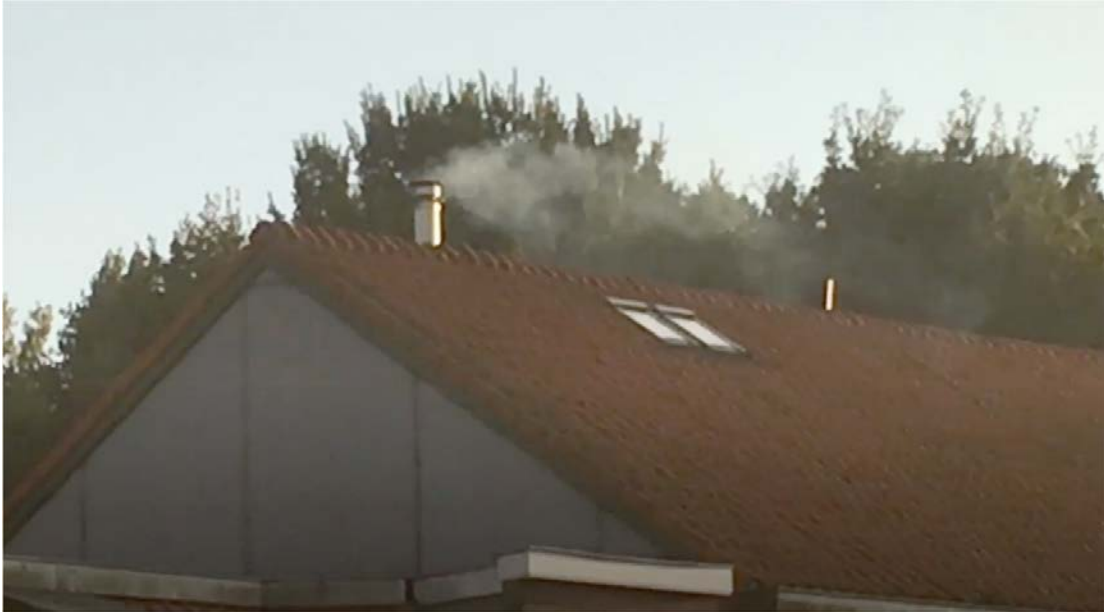
Afbeelding 8.14: Pluimasverlaging bij afvoer boven nokhoogte (foto STAB)
